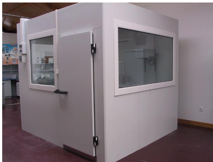
Figura 5. Sala de balanzas con temperatura e humidade controlada no IUMA (exterior)
